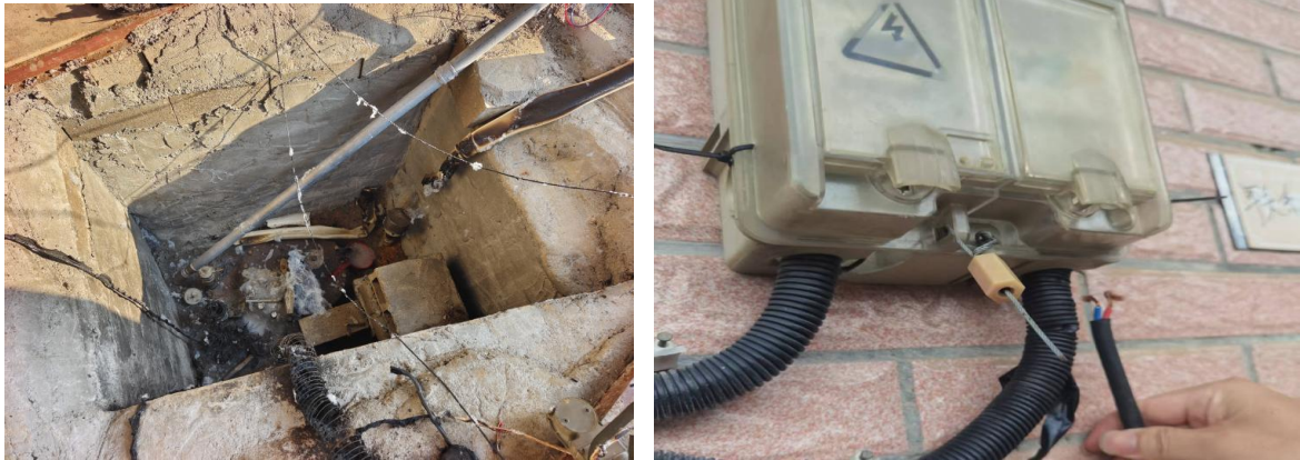
图6 彩钢板房供电线路电源线连接板房东侧居民楼入户电表内。彩钢板房进门1.2米处有一处地坑，宽1.1米，长1.6米，深1.4米，可见油罐进油口，连接输油管道，输油管与进油口接口处卡扣连接。油罐人孔阀门打开。
