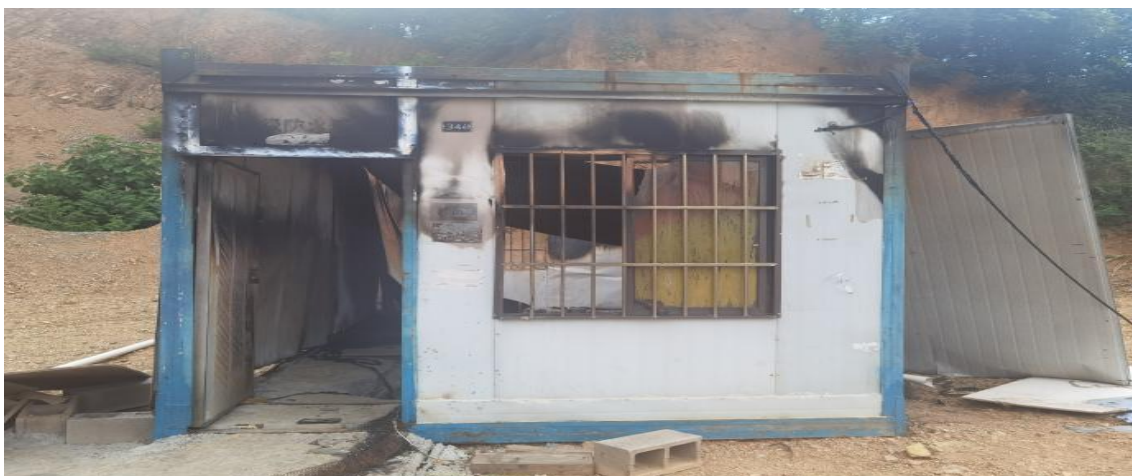
图7 彩钢板房南侧上部过火，有烟熏痕迹彩钢板房
