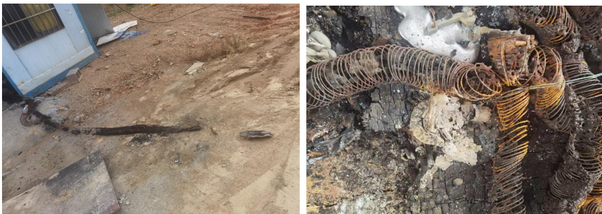
图5 彩钢板房门外已连接的输油管链接油罐车卸油口，输油管烧损。彩钢板房门内有输油管连接油罐车卸油口，输油管烧损。
