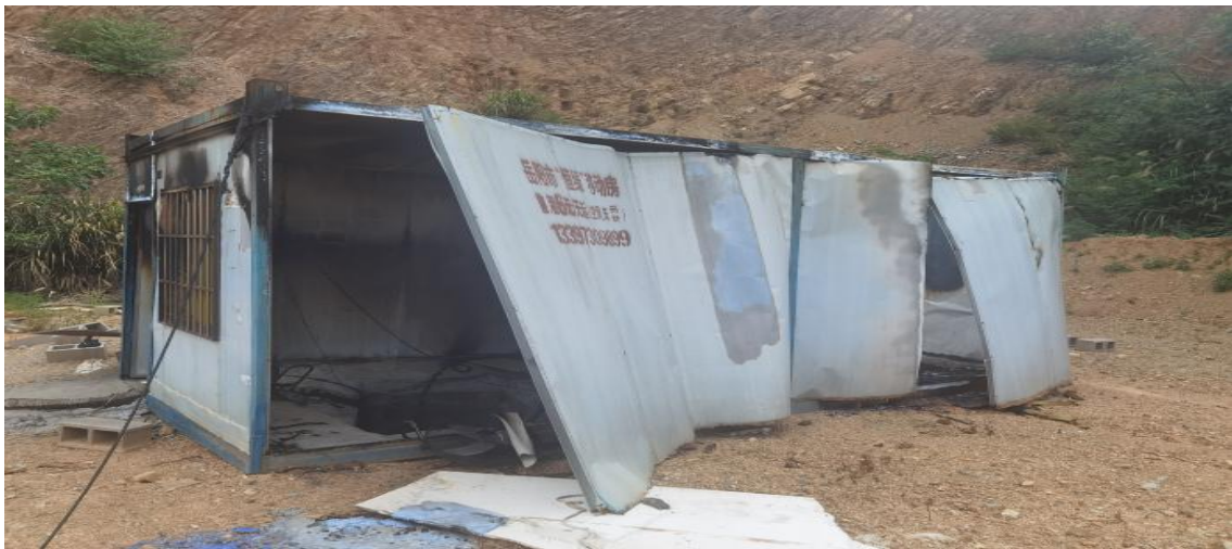
图9 彩钢板房东侧板房铁皮墙被冲破，上部有过火烟熏痕迹
