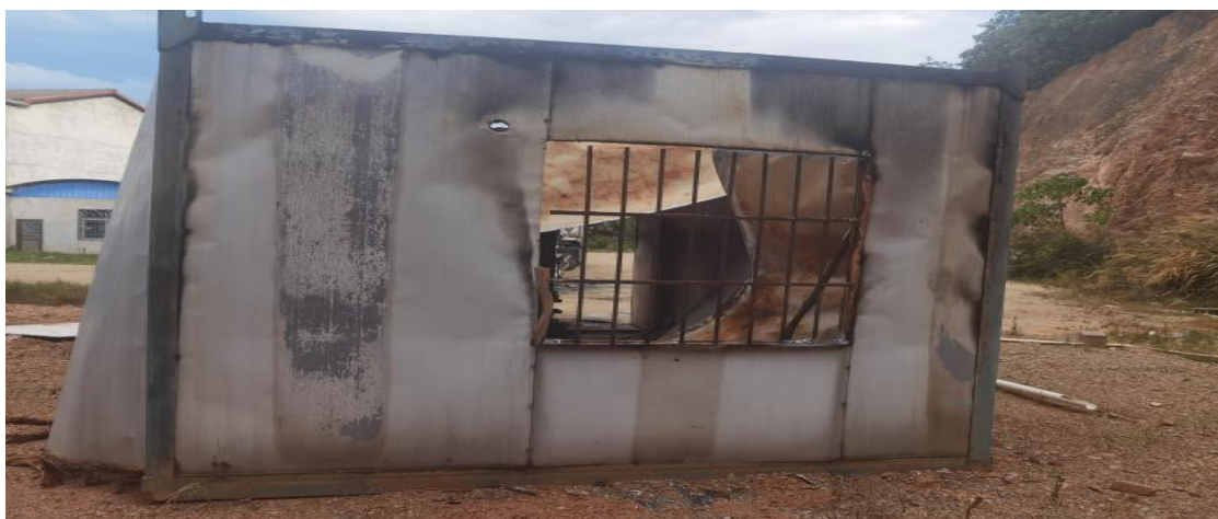
图10 彩钢板房北侧有过火痕迹
