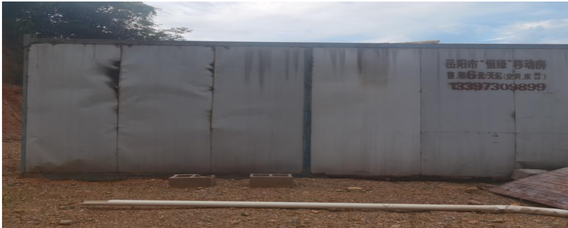
图8 西侧拼接缝隙处有烟熏痕迹
