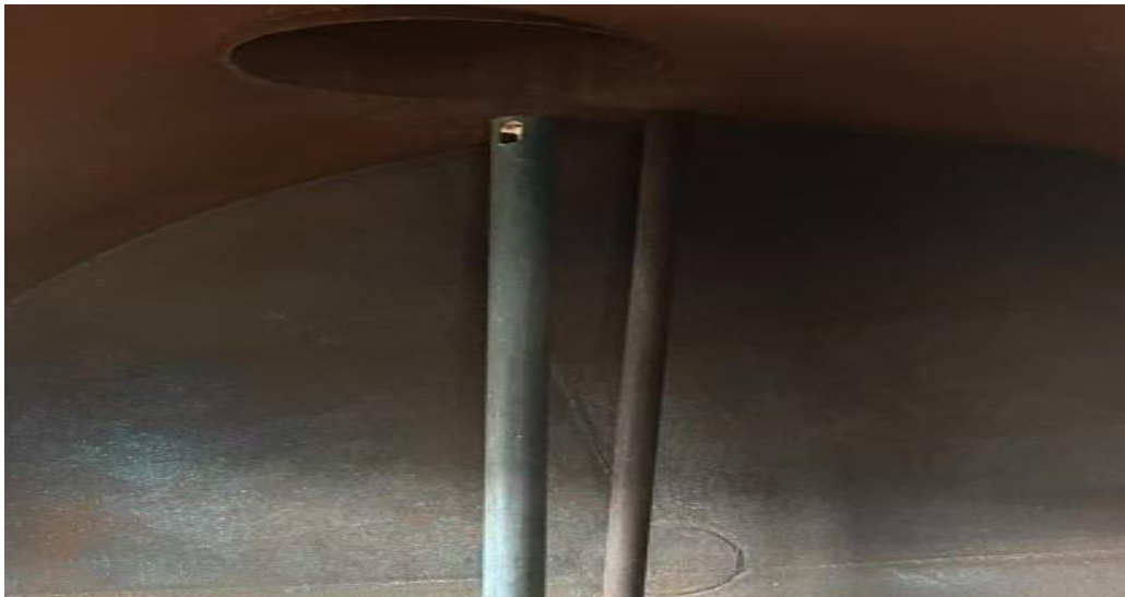
图 13 埋地罐进料管道靠罐顶孔（20*40mm）
