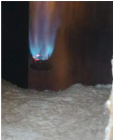
锦州石化加氢炉改造后火焰
